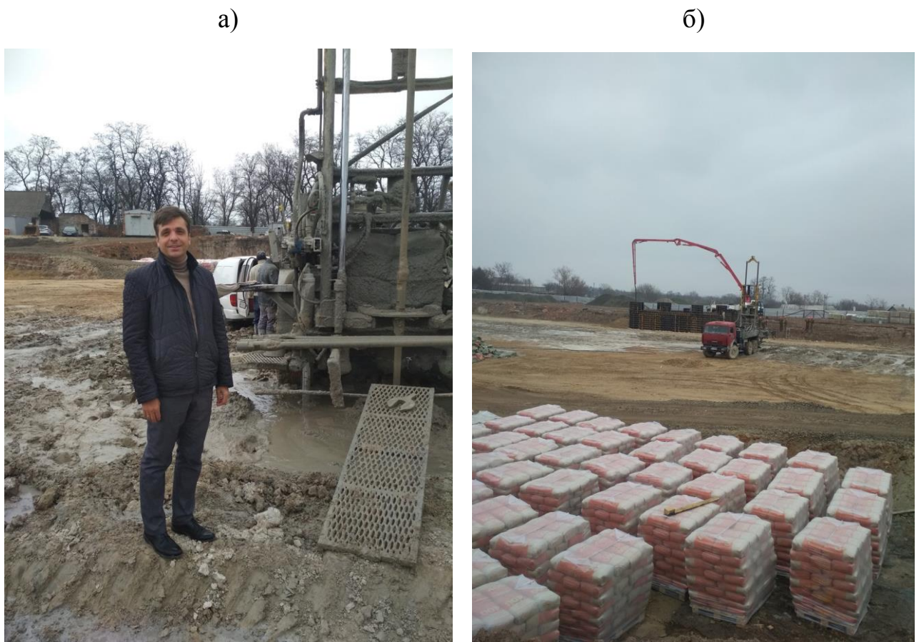
Рисунок 2.2 – Робота бурового станку під час створення мікропаль (а) та подача цементу під час реалізації бурозмішувальної технології (б)
