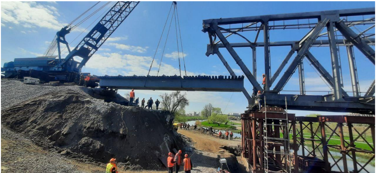
Рисунок 1.7. Використання пошкоджені металевої конструкції (ферми) (із звіту, 2022)
