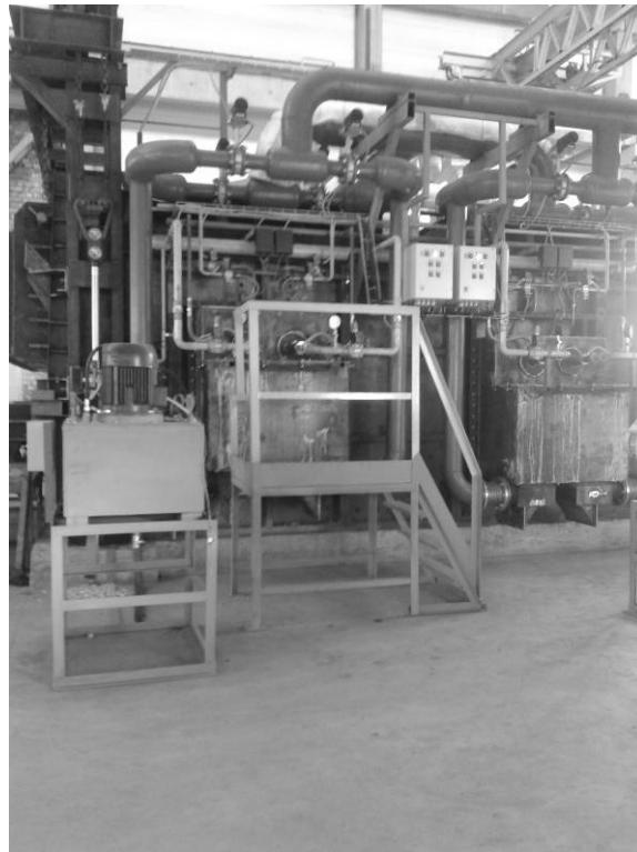
Рис. 3. Фото плавильной печи объемом 20 тонн. Фронтальный вид на систему отопления
