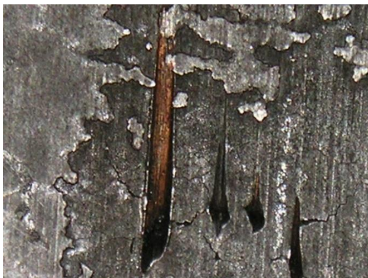
Рисунок 4.15 – Руйнування покриття на ділянках ерозії
